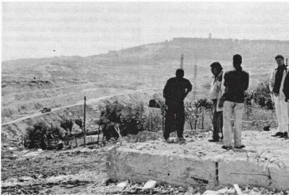
Salime zeigt auf die traurigen Reste seines Hauses, das kürzlich von der israelischen Armee zum vierten Mal mit Bulldozern niedergerissen wurde. Im Hintergrund ein israelisches Militärcamp und eine weitere Siedlerstrasse im Bau
